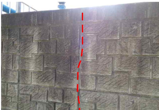
외부 벽체, 균열 (CW=0.2mm, L=2.5m)
