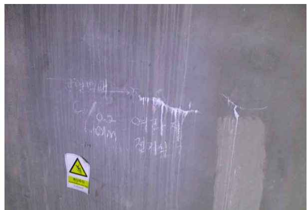
지하층 벽체 균열부 백태 (L=8.0m)
