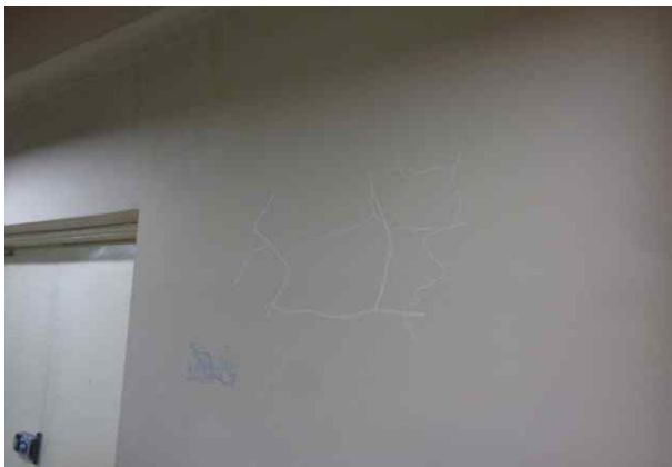
내부 벽체, 마감 망상균열 (A=18.0m×1.5m)
