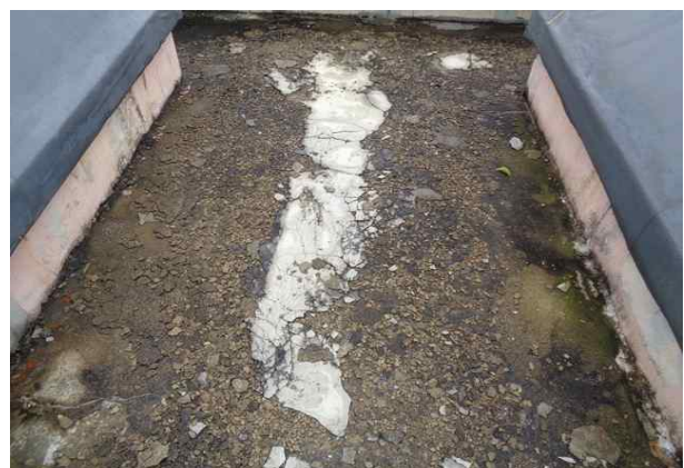
옥상층 바닥 콘크리트 박리 (A=5.0m×5.0m)
