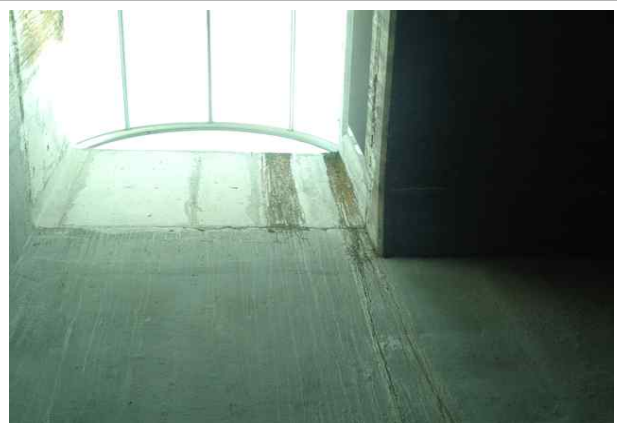
내부 지하층 벽체 누수흔적 (A=0.5m×5.0m, 2EA)
