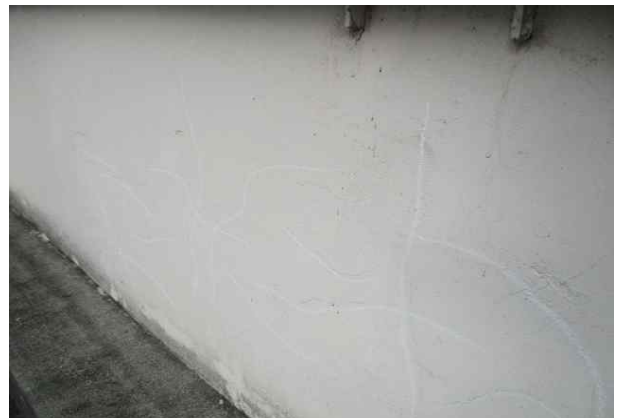
옥상층 벽체 마감 망상균열 (A=0.5m×5.0m)
