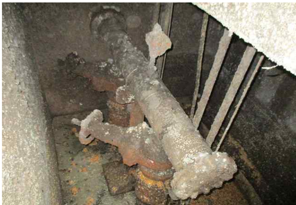
내부 설비, 부식(A=1.0m×2.0m)
