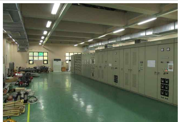
1층 전기실 전경
