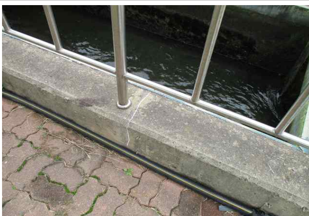
외부 벽체 균열 (CW=0.2mm, L=0.3m, 3EA)
