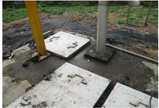
외부 바닥, 표면박리(A=2.5m×1.0m)
