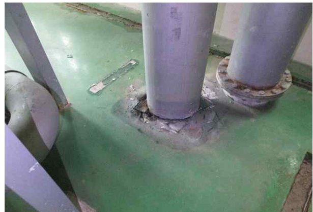
내부 바닥 박리 및 박락 (A=0.5m×0.5m)
