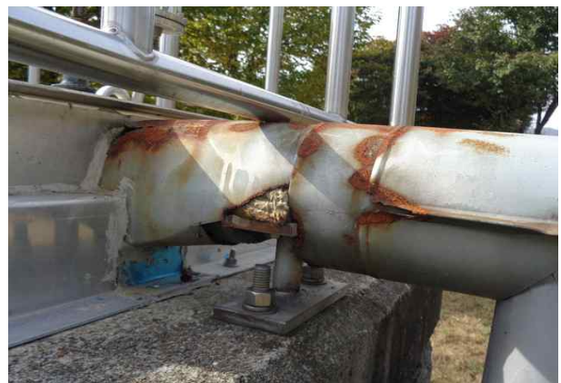
외부 설비, 부식 및 파손 (A=1.0m×2.0m)
