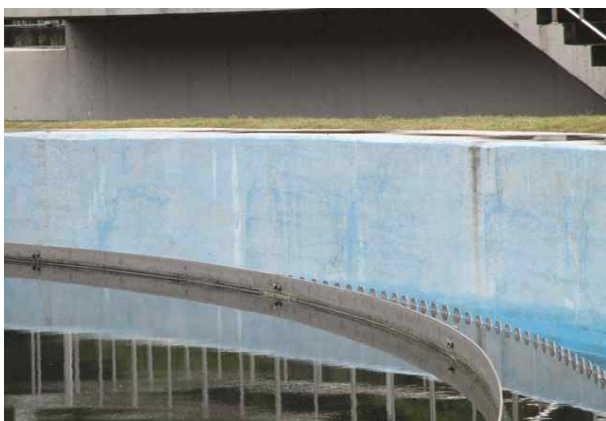
2지 내,외부 벽체 균열 및 백태 (CW=0.2mm L=3.0m, 87EA)
