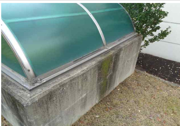
A-Line 채광창 실리콘 파손 (L=1.0m)
