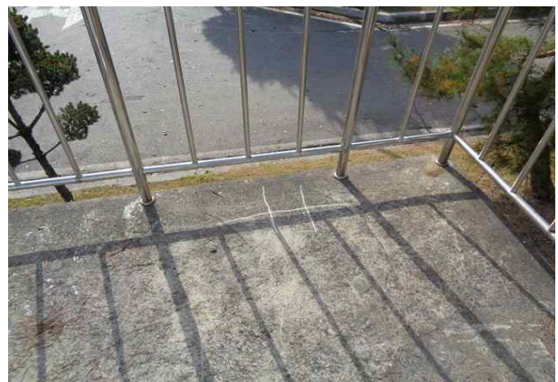
외부 바닥, 균열 (CW=0.2mm, L=2.0m)
