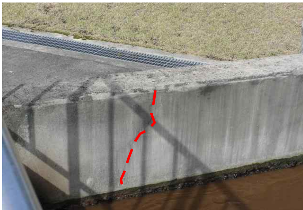
내부 벽체, 균열 (CW=0.2mm L=1.0m, 2EA)
