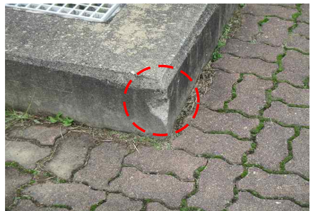
외부 벽체 콘크리트 파손 (A=0.1m×0.1m)
