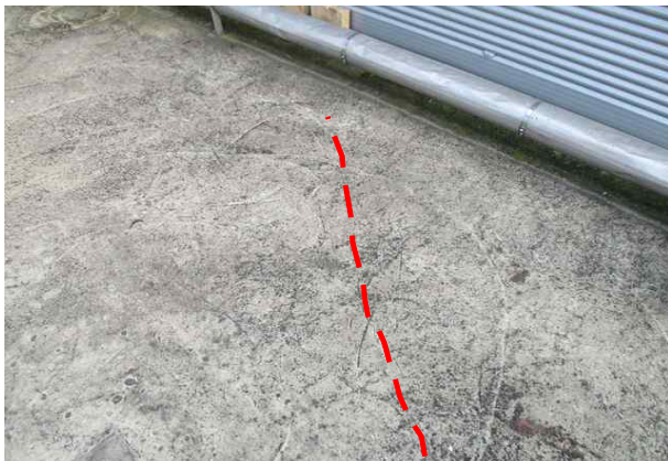
외부 바닥 균열 (CW=0.3mm, L=2.0m)
