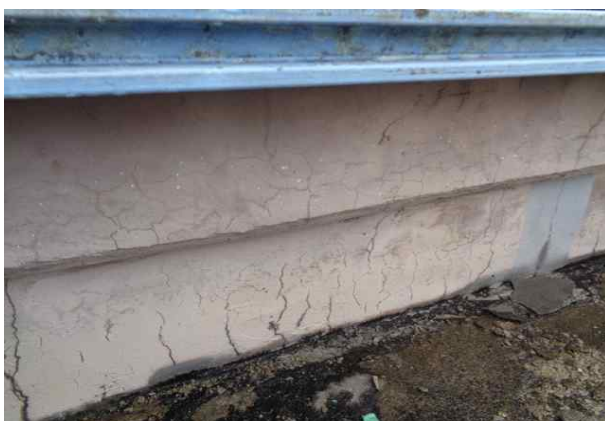
옥상층 벽체 마감 망상균열 (A=23.0m 2 )
