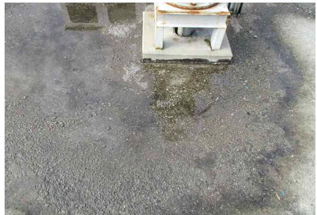
외부 바닥 표면박리 (A=4.0m×4.0m)
