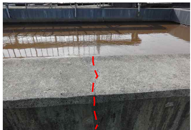
선택조 및 혐기성조 벽체 균열 (CW=0.2mm, L=1.5m)
