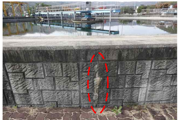
2지 외부 벽체 균열 및 백태 (L=1.0m)
