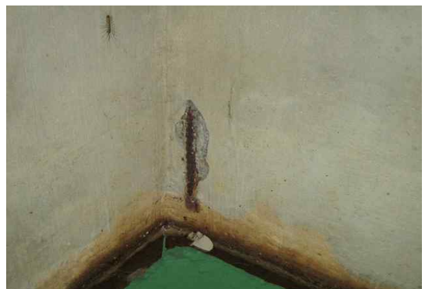
내부 지하층 벽체 철근노출 (A=0.5m×0.5m)
