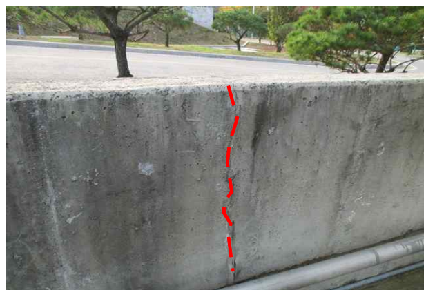
외부 벽체 균열 (CW=0.3mm, L=2.5m, 15EA)
