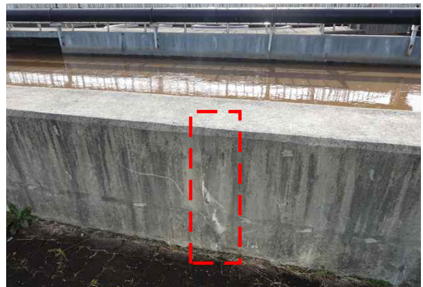
선택조 및 혐기성조 벽체 균열 및 백태 (CW=0.1mm, L=1.0m)
