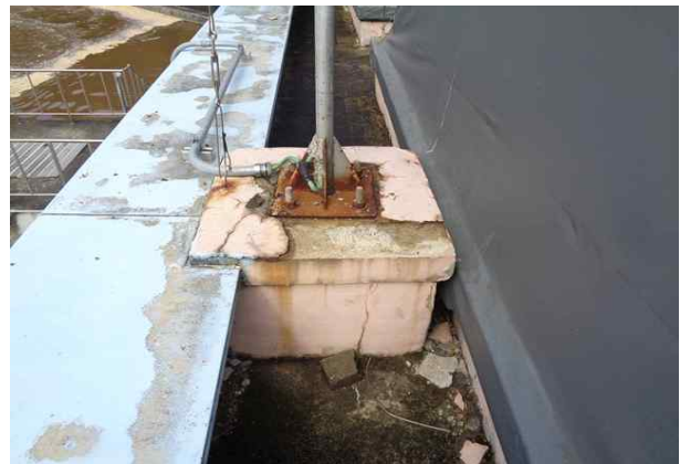
옥상층 피뢰침 받침부 부식 및 콘크리트 파손 (A=1.0m×1.0m)
