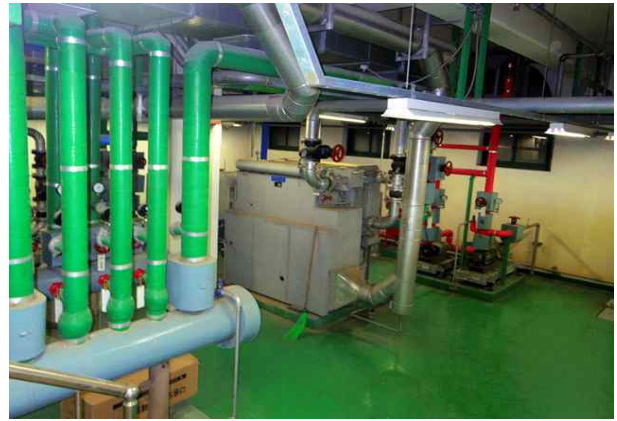
지하층 기계실 전경
