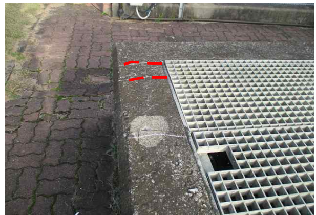
외부 바닥, 균열 (CW=0.2mm, L=0.2m, 2EA)
