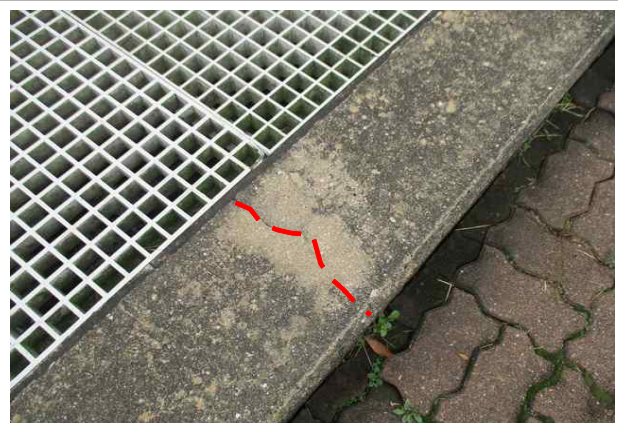
외부 바닥 균열 (CW=0.2mm, L=0.3m, 8EA)
