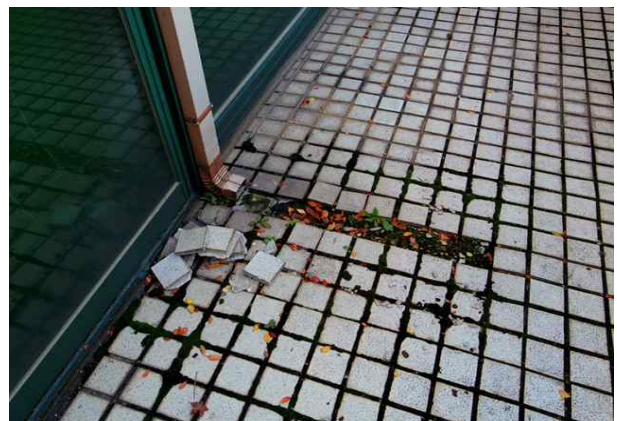
외부 바닥 타일 탈락 (10EA)
