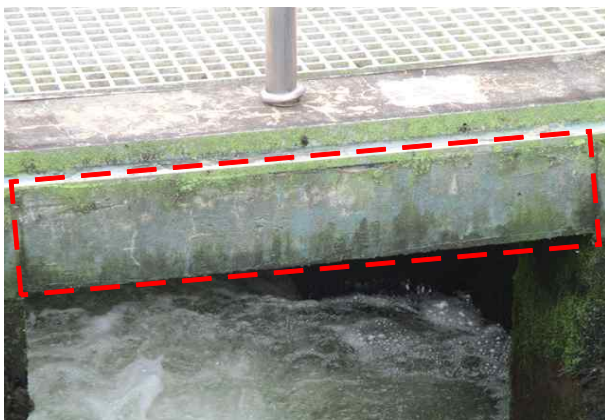
외부 벽체 망상균열 (A=0.2m×1.5m)
