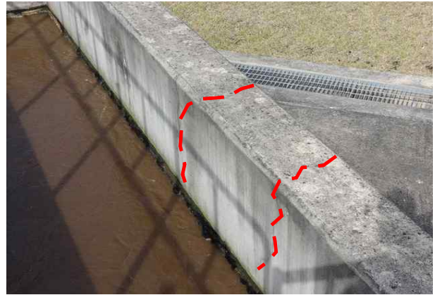
내부 벽체, 균열 (CW=0.2mm L=1.0m, 4EA)
