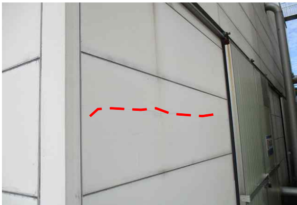
내부 벽체 마감재 균열 (CW=0.2mm, L=2.0m)
