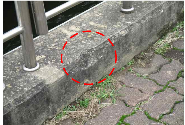
외부 벽체 콘크리트 파손 (A=0.1m×0.2m)
