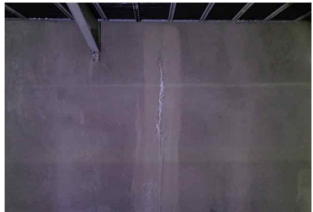
A-Line 벽체 누수 및 백태 (A=0.1m×0.5m)
