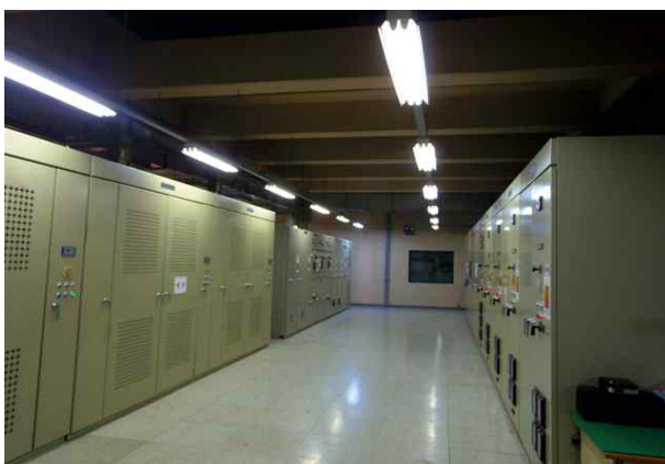
1층 전기실 전경
