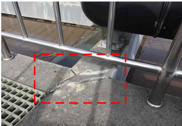
선택조 및 혐기성조 바닥 콘크리트 박리 및 박락 (A=0.3m×0.5m)
