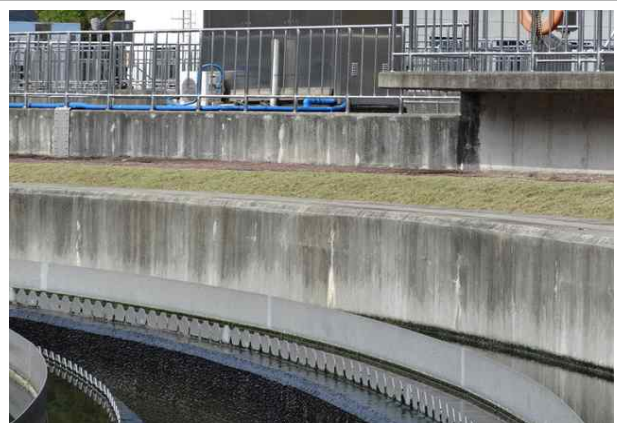
2지 내부 벽체 균열 및 백태 (L=1.0m, 36EA)
