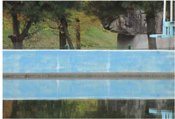
1지 내,외부 벽체 균열 및 백태 (CW=0.2mm L=3.0m, 65EA)
