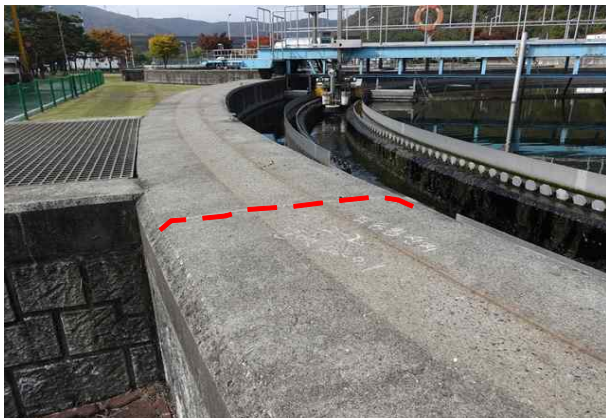
2지 외부 벽체 균열 (CW=0.1mm, L=1.0m, 4EA)
