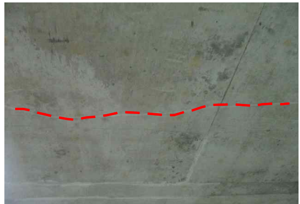
내부 지하층 천장 균열 (CW=0.2mm, L=3.0m)
