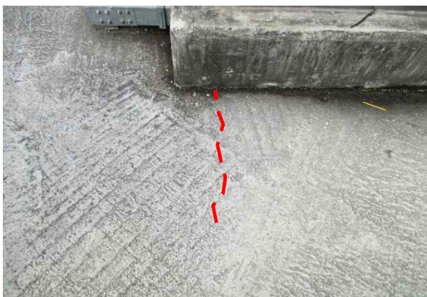
외부 바닥 균열 (CW=0.2mm, L=0.3m)
