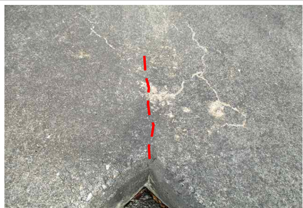
외부 바닥 균열 (CW=0.2mm, L=0.5m)
