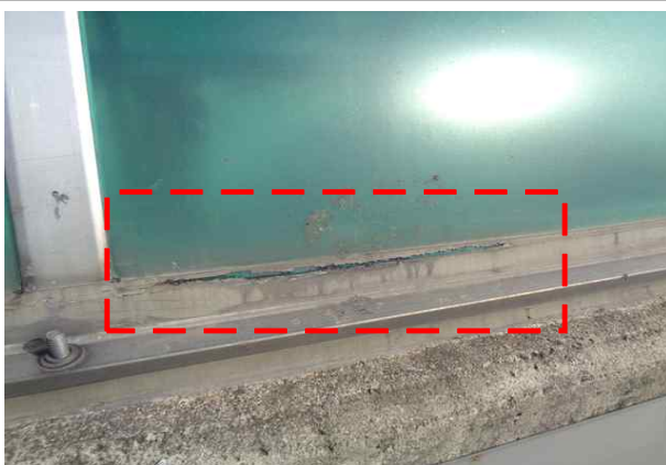
외부 채광창 실리콘 파손 (L=8.0m)
