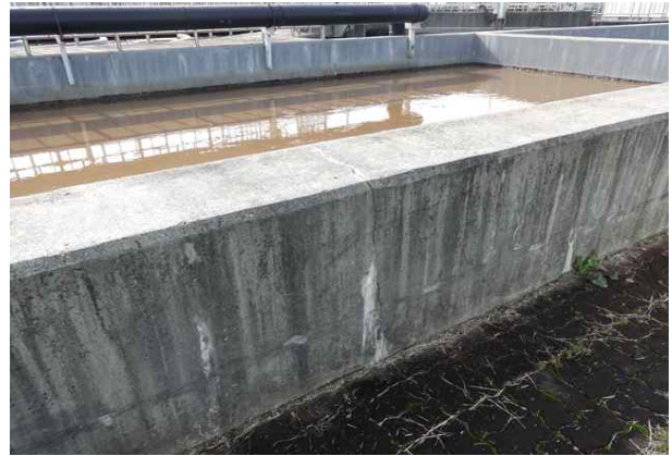
선택조 및 혐기성조 벽체 균열부 백태 (A=0.1m×0.5m)
