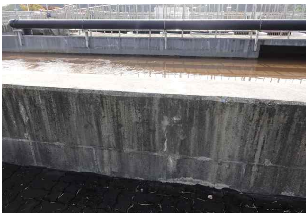
선택조 및 혐기성조 벽체 균열 및 백태 (CW=0.1mm, L=1.0m)
