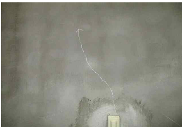
내부 지하층 벽체 균열 (CW=0.2mm, L=1.0m)
