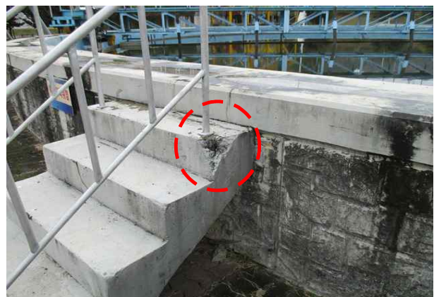
2지 외부 계단 콘크리트 파손 (A=0.2m×0.2m)
