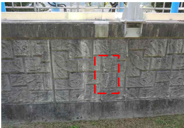
외부 벽체, 균열 및 백태 (A=0.1m×1.5m)
